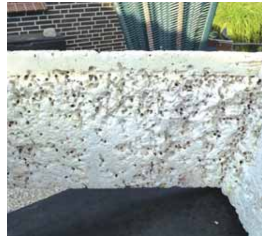
Wachsmottenschäden durch fehlerhafte Einwinterung.
